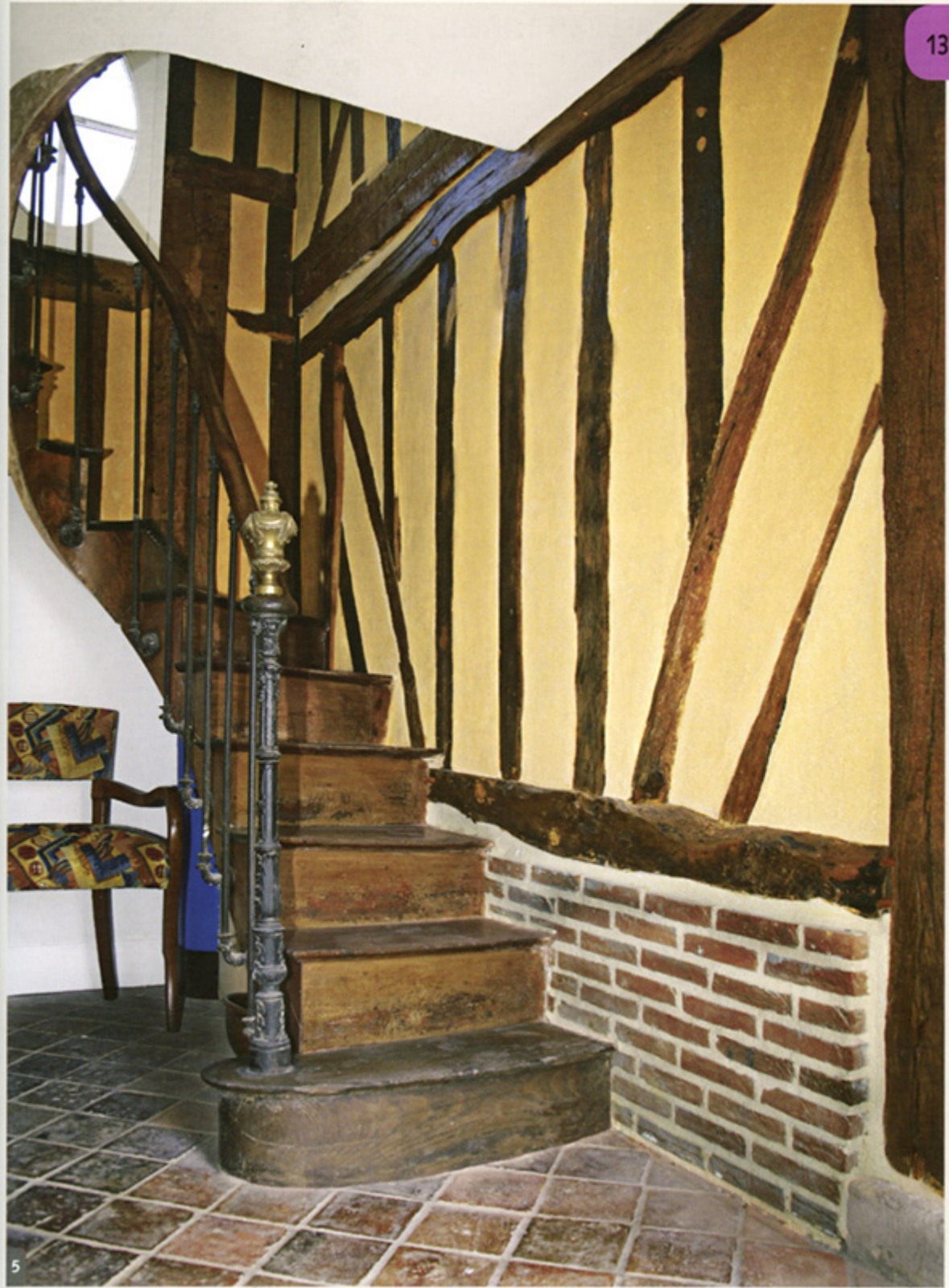
Sur un remplissage refait de neuf avec un béton de chanvre, on applique un enduit de finition à la chaux.
