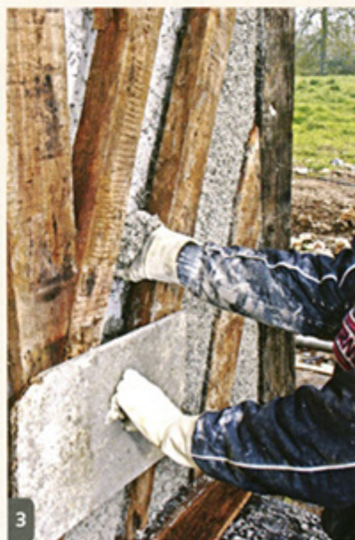
En plaquant une taloche en applique sur les bois, le béton est calé au nu de la structure.
