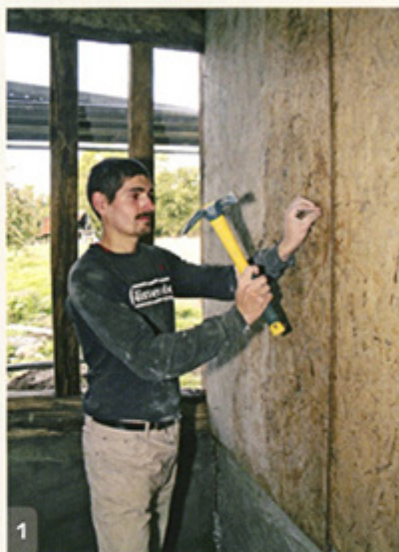
D'un côté du colombage, on fixe des panneaux de coffrage pour retenir le béton au cours du remplissage.
