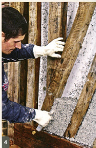
Une fois la taloche retirée, on écrase le béton de chanvre avec une truelle pour obtenir un retrait nécessaire à la couche d'enduit de finition.
